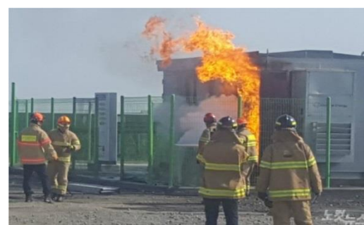
군산 태양광 발전소 ESS화재 (6.15)
